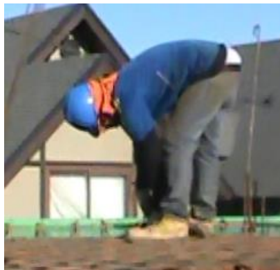
Figura 17. Postura de trabajo al efectuar amarre de fierros en losa del primer piso.
