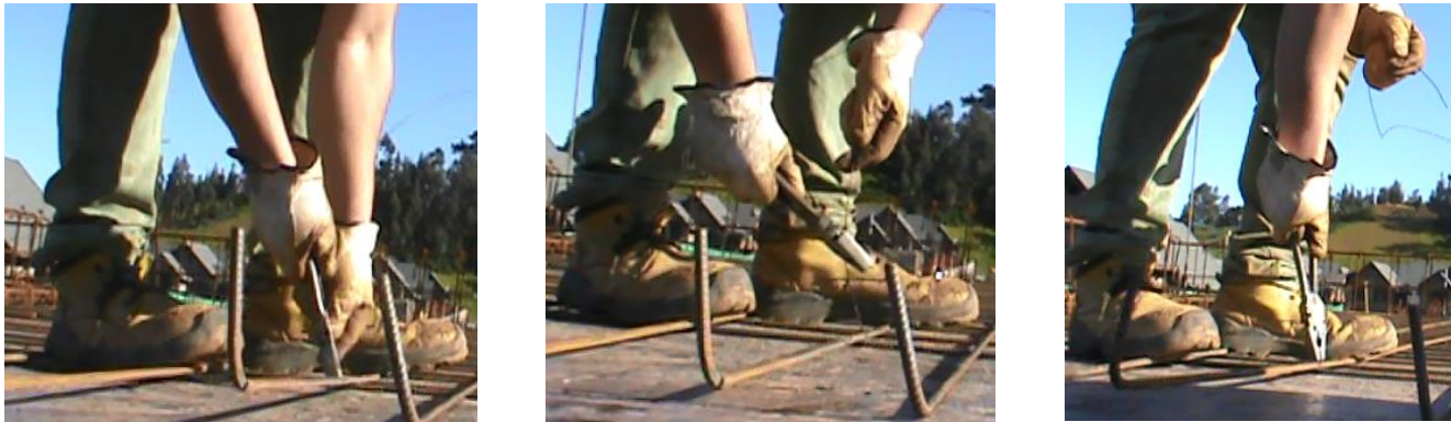
Figura 16. Etapas del ciclo de amarre de fierros al armar la primera malla de la losa del primer piso.
